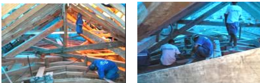
Figura 5 - Trabalhos de limpeza do forro de estuque com a remoção das peças de madeira da estrutura da cobertura (peças danificadas). Fonte: Acervo da autora-2006
