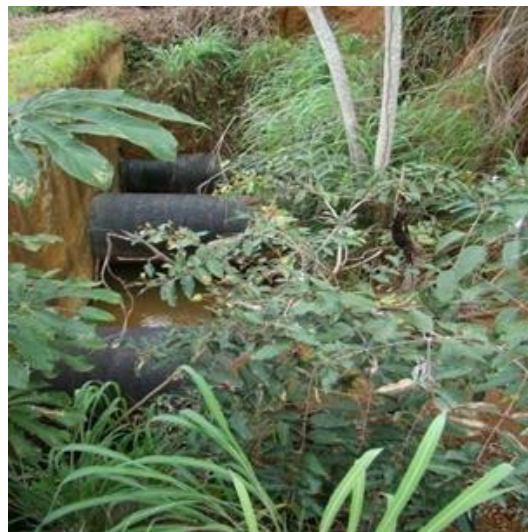
Figura 1.10: Tubulação da Tomada de Água entre o talude e o dissipador de energia
