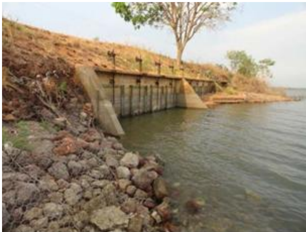
Figura 1.13: Tomada de água
