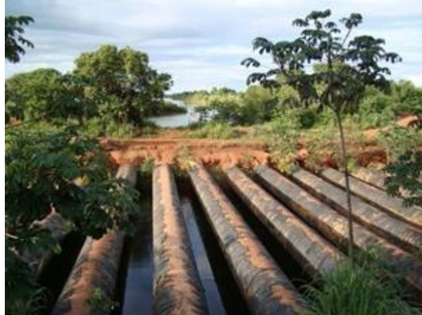
Figura 1.15: Tubulação de descarga na Adutora Rodoarte
