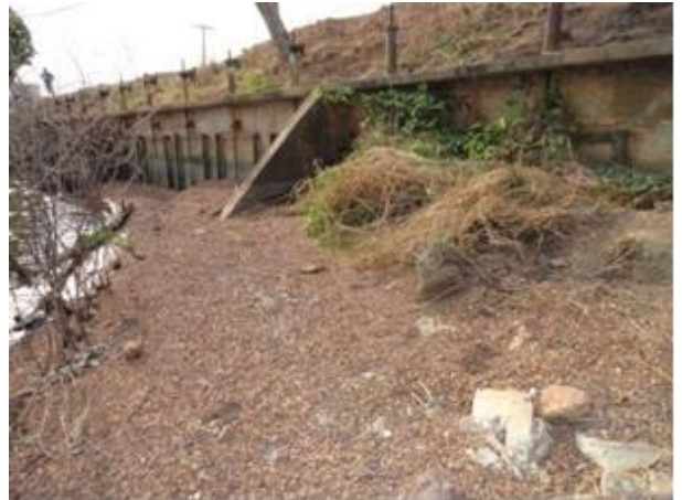
Figura 1.12: Situação das comportas da tomada de água
