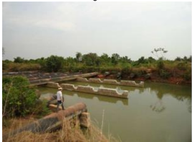
Figura 1.21: Tubulação de descarga da tomada de água
